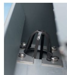
Gouttières équipées de crépines pour un bon écoulement des eaux pluviales
